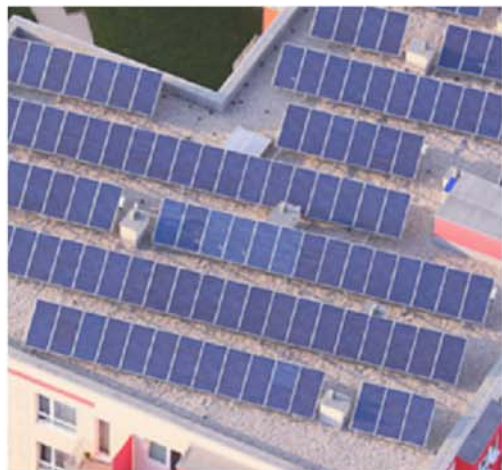
Impianto fotovoltaico su tetto condominiale (foto ENEA)
